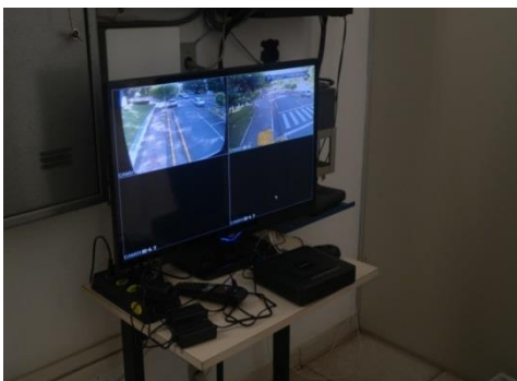
Figura 3. Central de monitoramento
