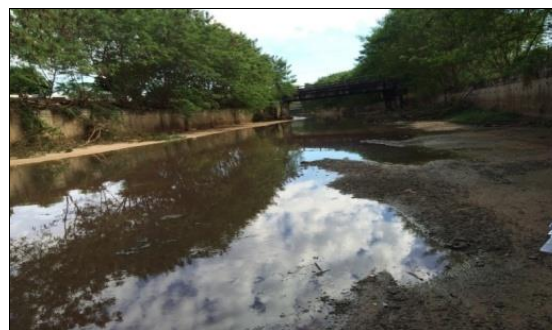
Figura 4. Estado de assoreamento.
