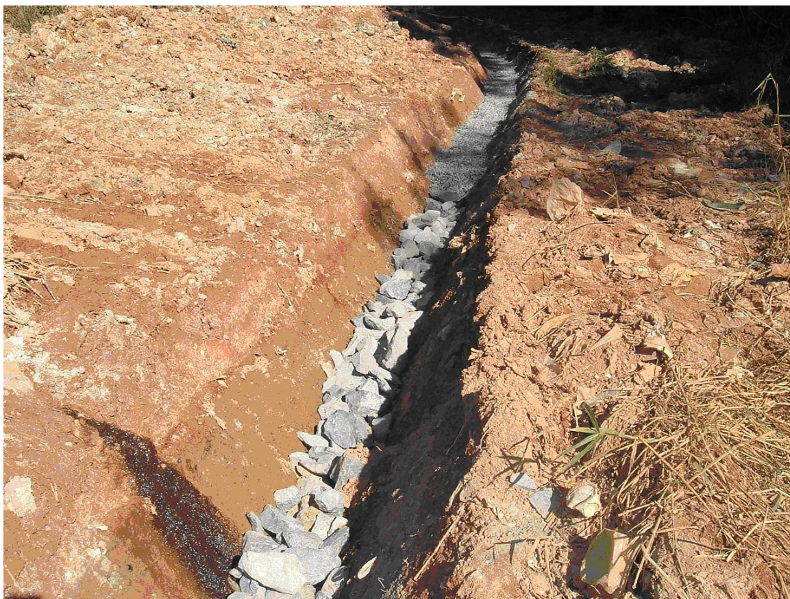
Figura 11. Dreno para captação do chorume gerado no aterro de Poços de Caldas – MG (Foto: Paulo Junker Menezes, maio de 2005).
