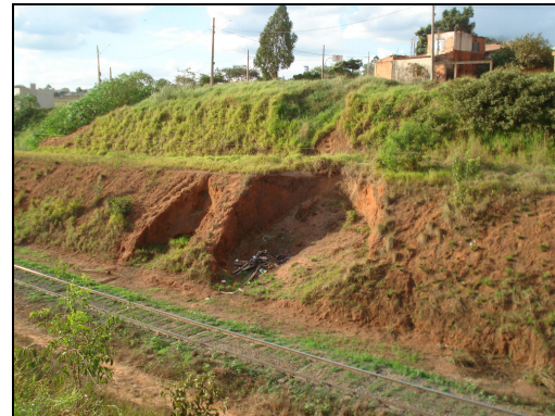
Figura 3. Sulco erosivo as margens da linha férrea.
