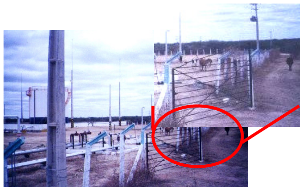
Figura 14 – As estações coletoras apresentam vulnerabilidades de suas estruturas e riscos a acidentes.
