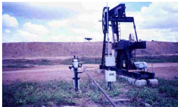
Figura 20 – Área de pecuária, onde a estrutura do poço encontra-se fora das normas de segurança.
