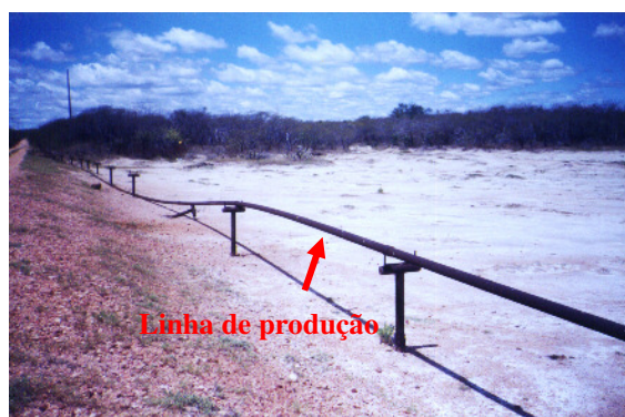
Figura 8 – Aspectos de deterioração dos cavaletes de sustentação e duto em risco de corrosão pela água do mar.
