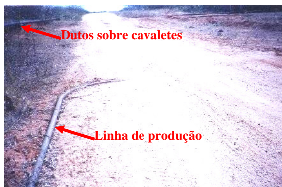
Figura 5 – Risco observado no cruzamento das linhas de produção com as estradas e sem sinalização ou de serviço.
