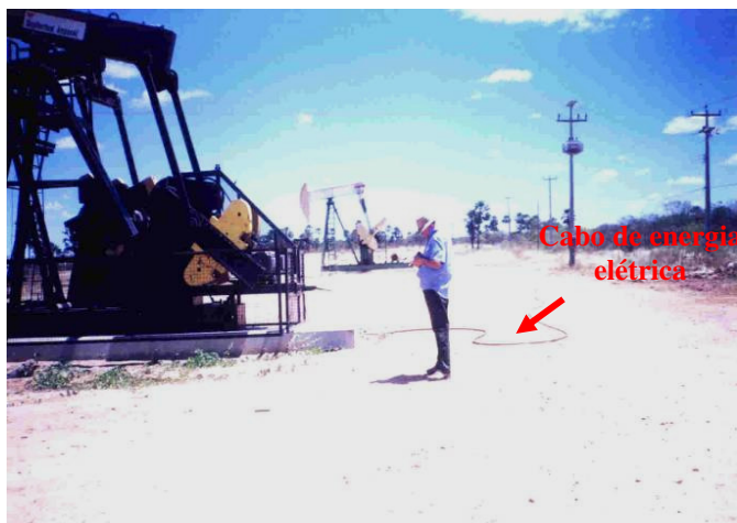
Figura 10 – Cabo de energia elétrica solto no solo, sobre o qual há tráfico de veículos.
