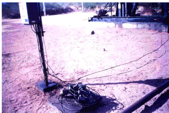
Figura 11 – O óleo jorrado atinge a instalação elétrica da estação automática de transmissão de dados.
