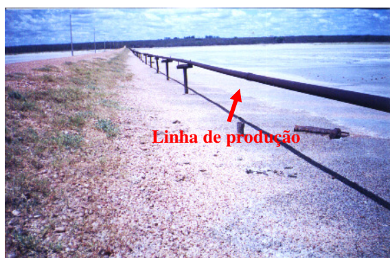
Figura 7 – Linha de produção do poço CAM-268. Deterioração dos cavaletes de ferro pela água do mar.
