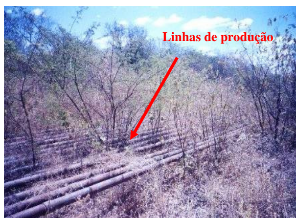
Figura 3 – Linhas de produção sem estar de acordo com as normas de segurança.
