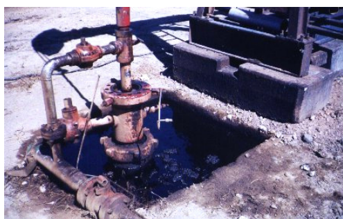
Figura 13 – Cisterna entupida com acúmulo de óleo, com risco de incêndio e de infiltração no solo.
