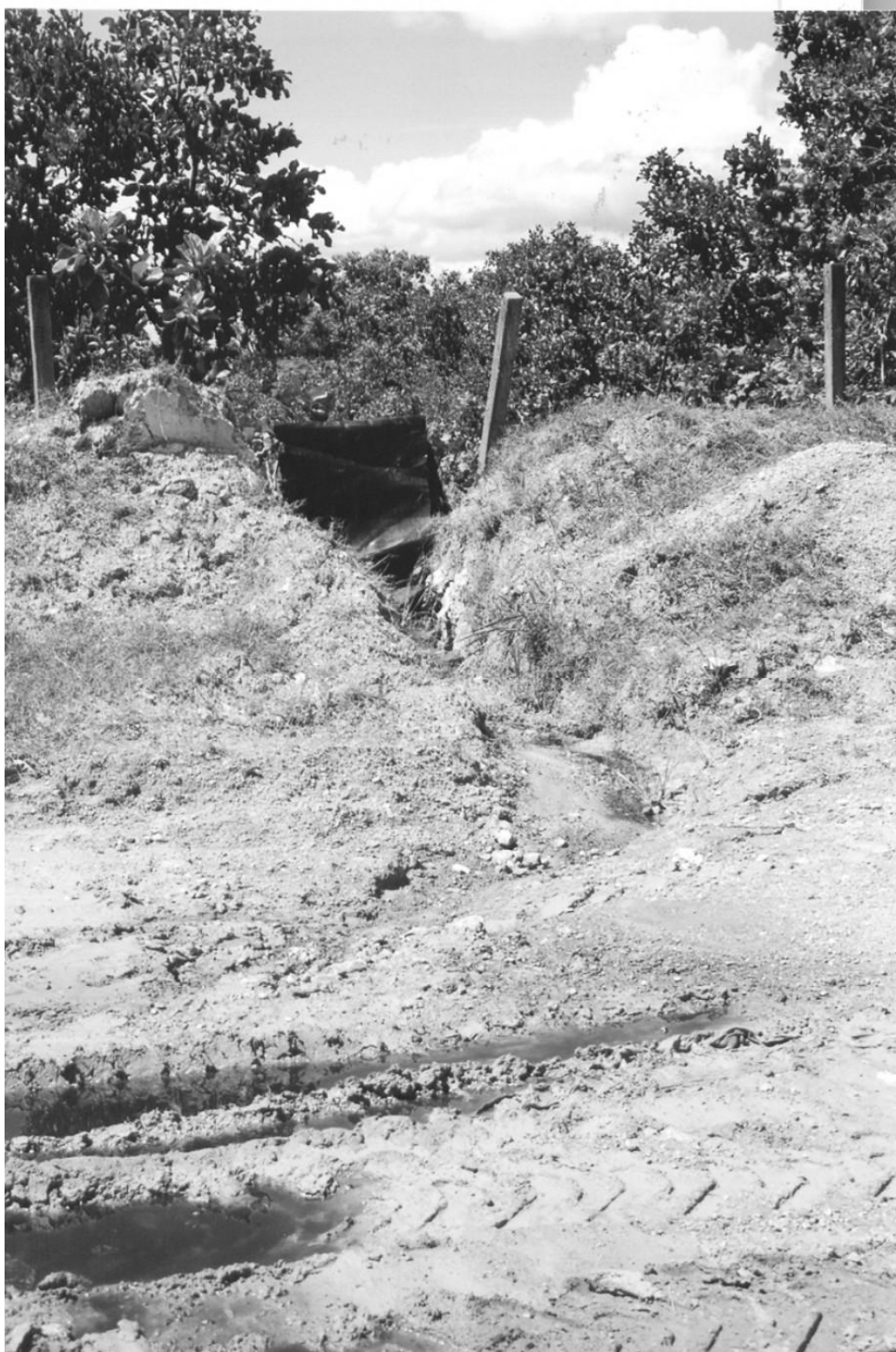
Figura 4. Ponto onde ocorre vazamento superficial do chorume para fora dos limites do aterro sanitário do município de Cuiabá. (Foto tirada por França Filho, em junho de 2006).
