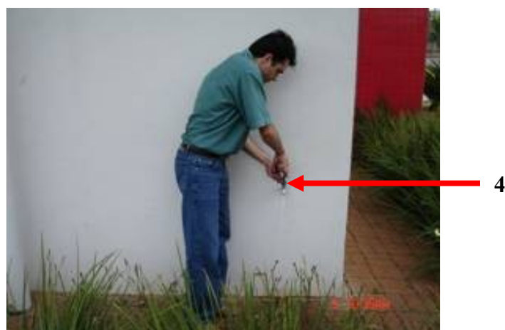
Figura 6. Torneira para coleta da água da cisterna que foi filtrada (Ponto de Coleta 4).
