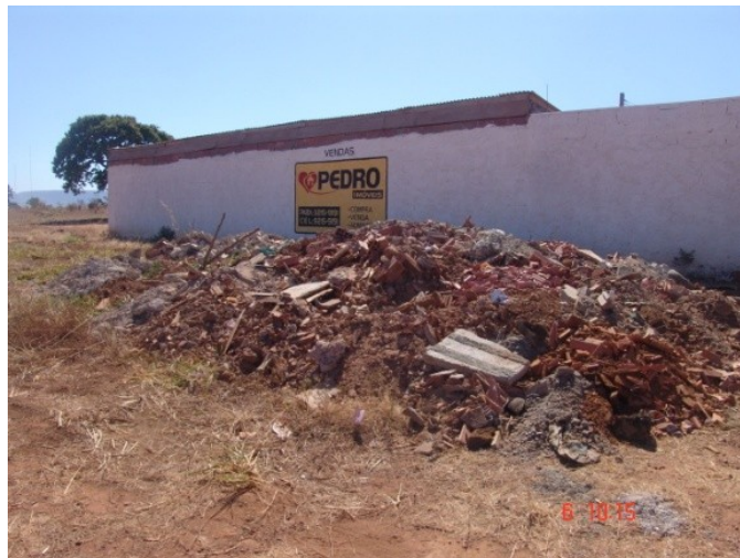
Figura 1: Disposição do RCC da obra do lado de fora do terreno.
